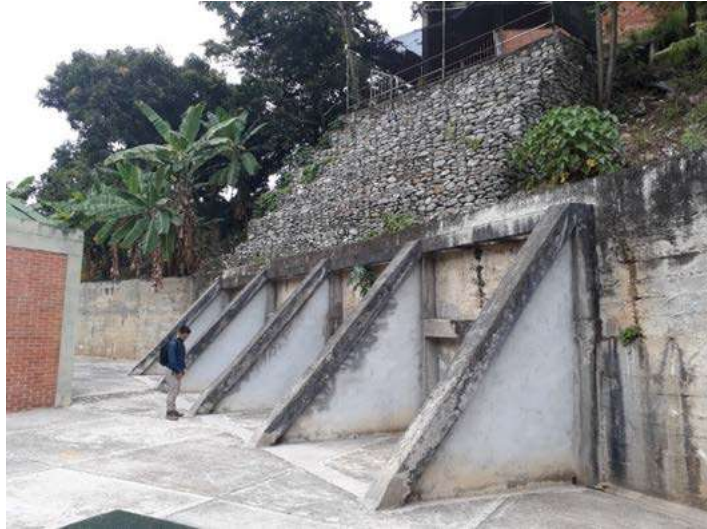
Gráfico 203. Municipio de Rioblanco. Punto en condición de riesgo por movimiento en masa en la Cabecera Municipal, localizado en las coordenadas -75,647081 E y 3,5304 N
