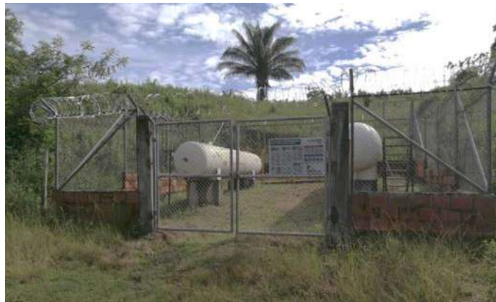
Imagen 54. Estación de Gas – Santiago Pérez
