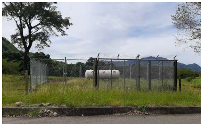
Imagen 55. Estación de Gas – Señoritas – Mesa de Pole
