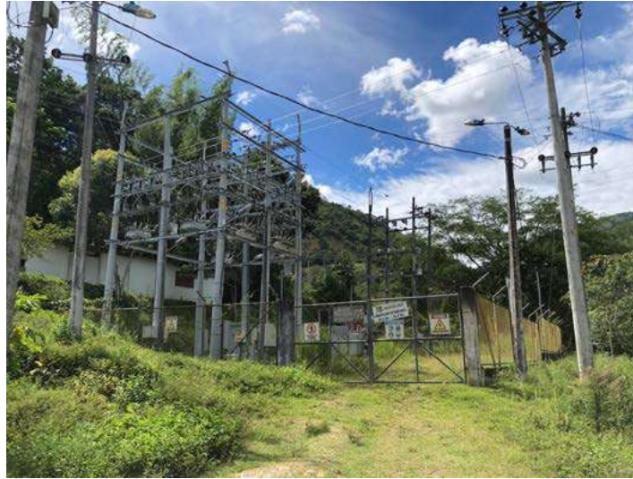
Gráfico 238. Subestación de energía eléctrica de Rioblanco
