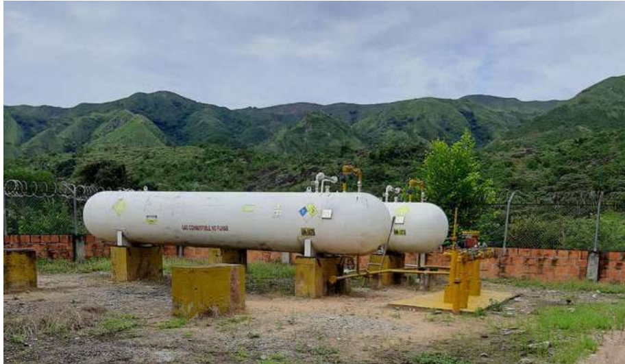
Imagen 53. Estación de Gas - Casco Urbano
