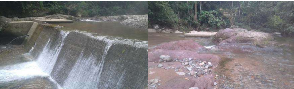
Imagen 40. Captación Sobre la Quebrada Paipita
