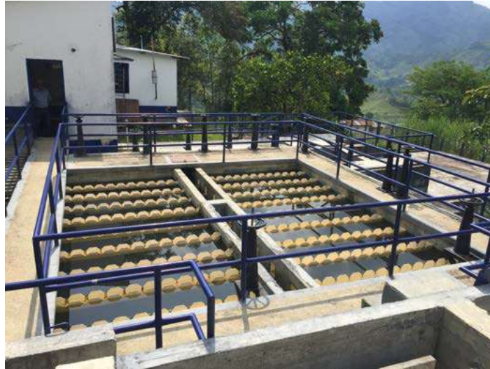
Gráfico 221. Municipio de Rioblanco. Sedimentadores de la planta de tratamiento de agua potable de la cabecera municipal
