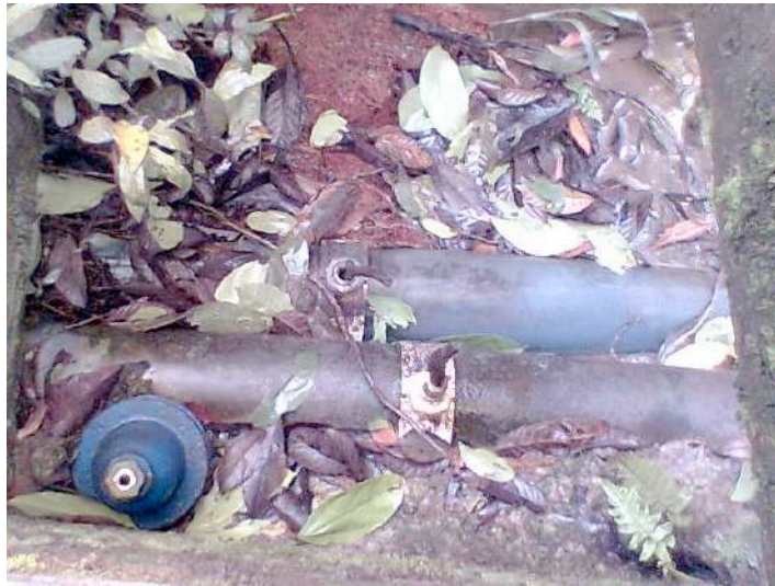
Gráfico 215. Municipio de Rioblanco. Vista de tuberías de aducción del acueducto de la cabecera municipal
