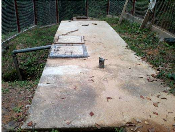
Gráfico 214. Municipio de Rioblanco. Infraestructura de desarenación del acueducto de la cabecera municipal
