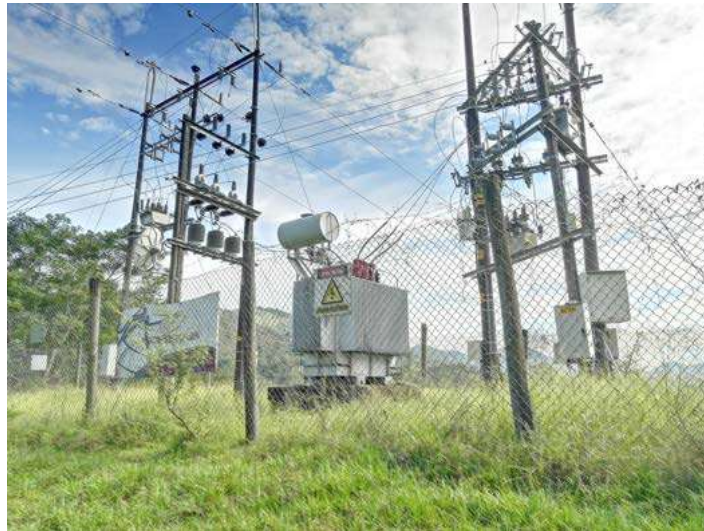
Imagen 51. Subestación Eléctrica Santiago Pérez
