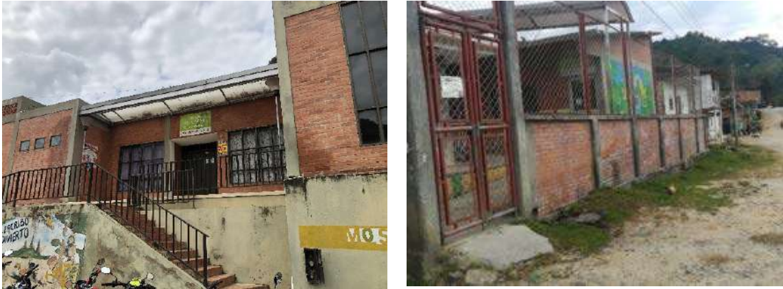
Gráfico 62. Municipio de Rioblanco. Infraestructura de los Centros de Desarrollo Infantil existentes en cabecera y centro poblado Herrera
