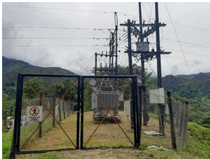
Imagen 52. Subestación Eléctrica Señoritas - Mesa de Pole
