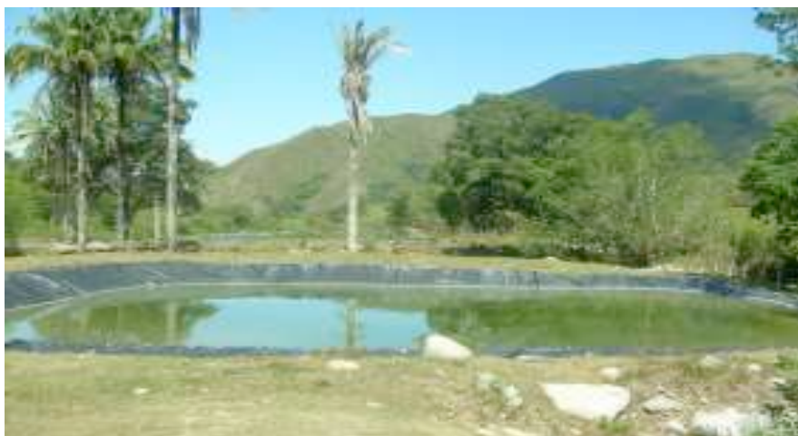
Gráfico 152. Municipio de Rovira. Primera laguna de oxidación (anaerobia) sistema de alcantarillado de cabecera
