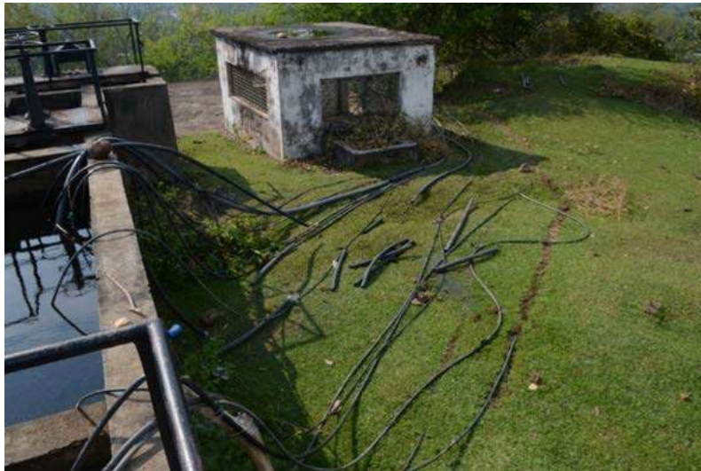
Imagen 41. Tuberías de Aducción
