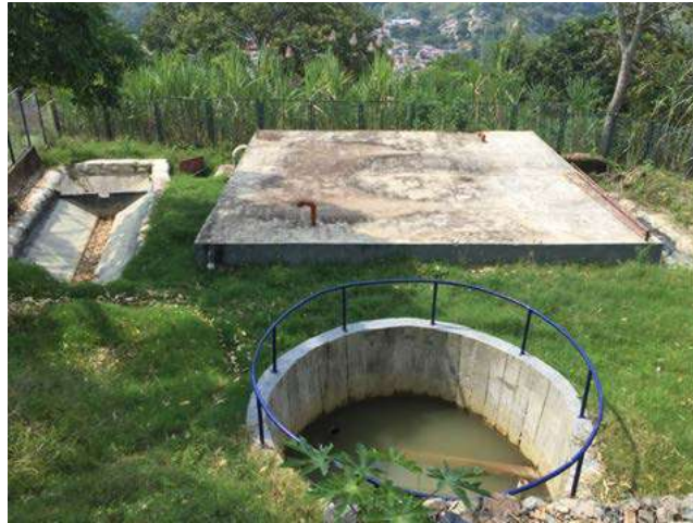
Gráfico 225. Municipio de Rioblanco. Tanque de almacenamiento de la PTAP de la cabecera municipal
