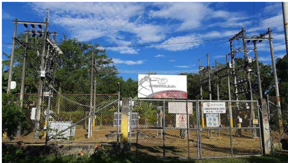
Imagen 49. Subestación de Energía Eléctrica de Ataco
