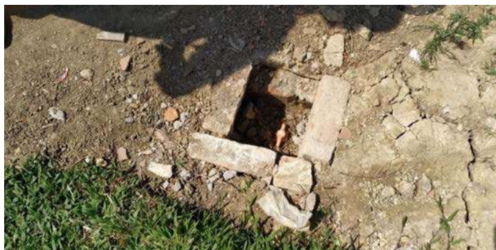
Imagen 33. Detalle del Punto de abastecimiento acueducto Asentamiento Nuevo Horizonte
