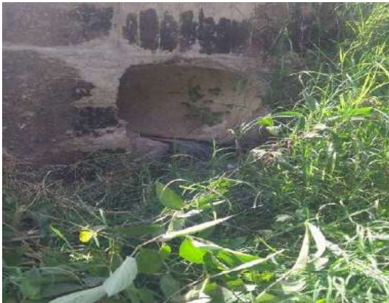
Vertimiento San José 2: Salida de agua por medio de un tubo en PVC
