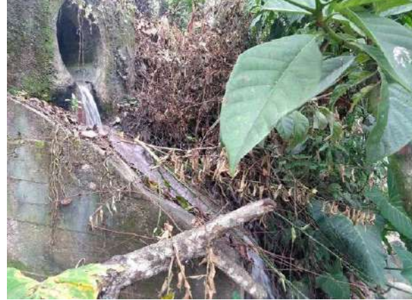
Vertimiento San José 1: Salida de aguas residuales por medio de un tubo de concreto de 10"
