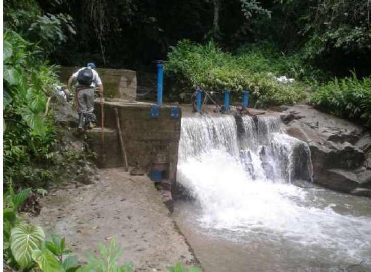
Gráfico 213. Municipio de Rioblanco. Infraestructura de captación del acueducto de la cabecera municipal en la quebrada El Quebradón
