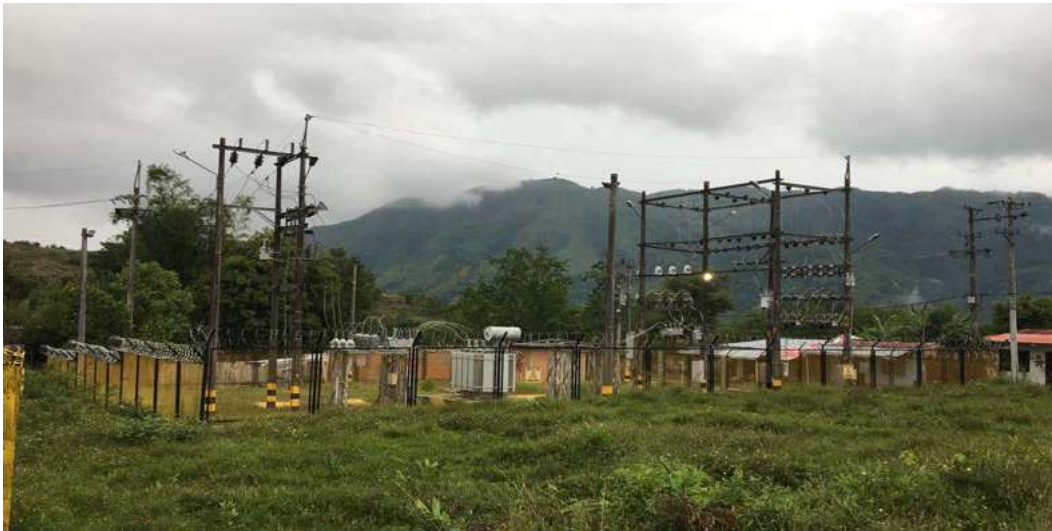
Gráfico 160. Municipio de Rovira. Subestación eléctrica ubicada en la cabecera municipal
