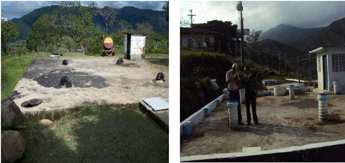
Gráfico 138. Municipio de Rovira. Tanques de almacenamiento del acueducto de la cabecera municipal
