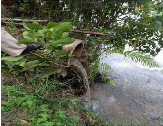
Vertimiento Barrio Buenos Aires: Caída de sus aguas directamente al río por medio de un tubo en concreto
