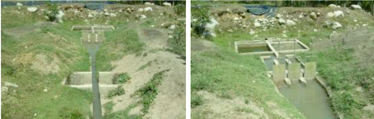
Gráfico 151. Municipio de Rovira. Canaleta de entrada de aguas residuales y sección de sedimentación y manejo de sólidos del sistema de tratamiento del alcantarillado de la cabecera municipal
