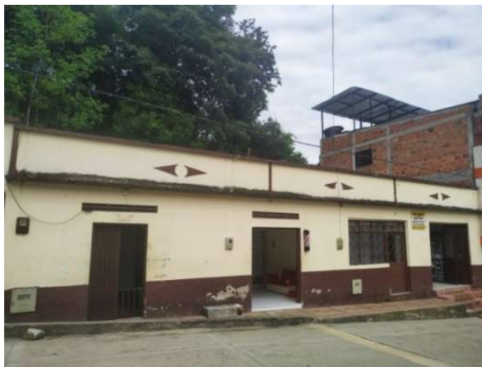
Gráfico 83. Municipio de Rioblanco. Fachada de vivienda en barrio Centro de la cabecera municipal
