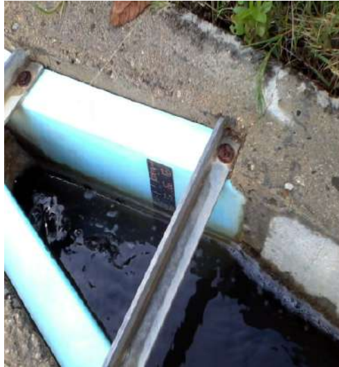
Gráfico 218. Municipio de Rioblanco. Imagen de rejilla medidora de la planta de tratamiento de agua potable de la cabecera municipal
