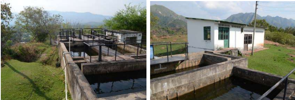
Imagen 44. Tanques de Floculación y Cloración
