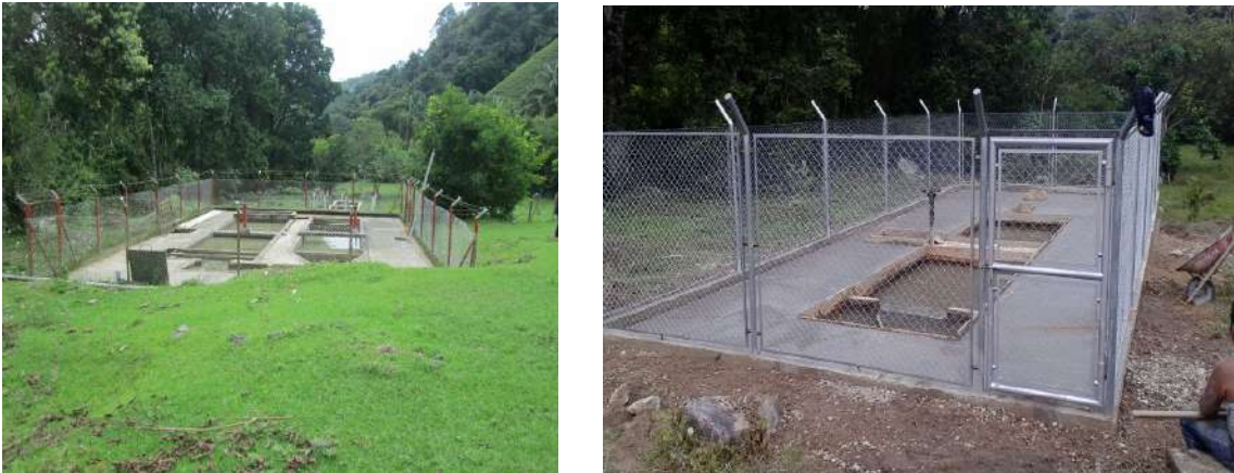
Gráfico 136. Municipio de Rovira. Desarenador línea de conducción acueducto cabecera municipal
