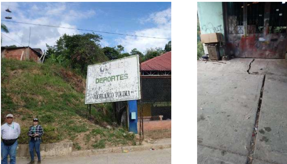
Gráfico 201. Municipio de Rioblanco. Puntos en condición de riesgo por movimientos en masa en la Cabecera Municipal, coordenadas -75,643954 E y 3,528237 N y -75,646617 E y 3,52995 N
